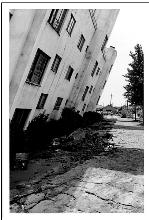
写真1 傾いている県営住宅
