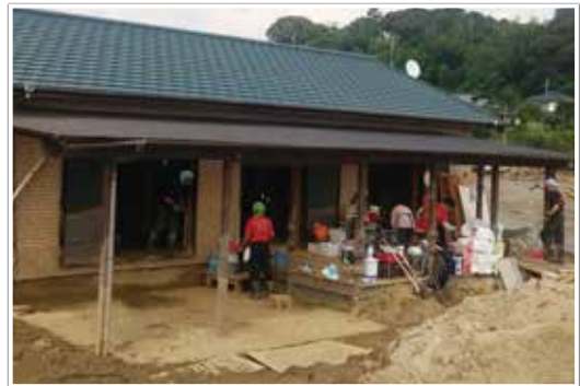
家屋からの泥出しの様子（福岡県朝倉市）
