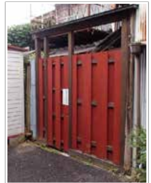
緊急避難扉（設置後）
