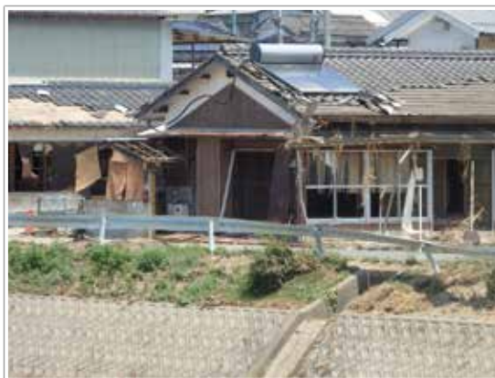
被災した住宅（愛媛県西予市）
