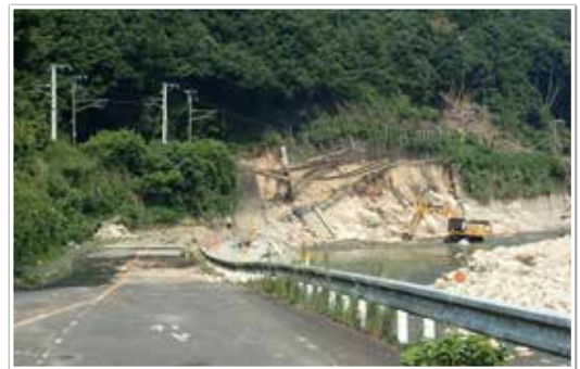
広島県東広島市（JR山陽線被災現場）
