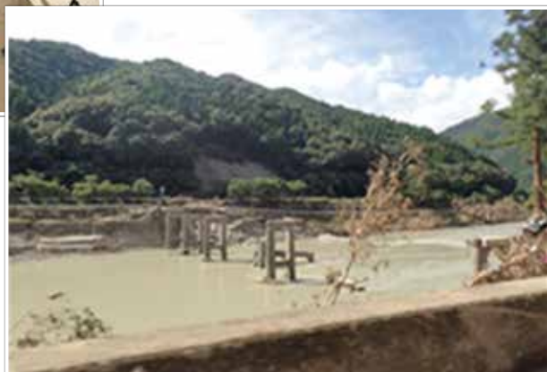
写真2 球磨川の氾濫流による橋梁の破損状況
