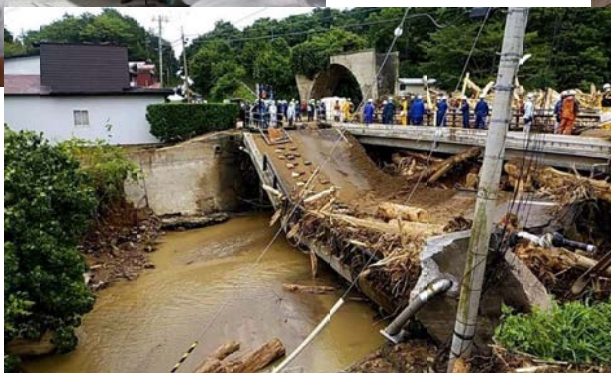
崩落した橋と堆積した流木の視察
