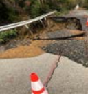
珠洲市(道路崩落)
