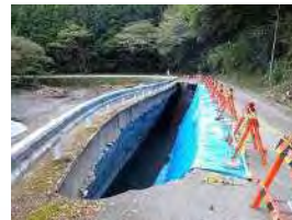
2022年9月、台風第15号災害時の静岡県川根本町。車で地区内見回り中の区長・副区長が路肩決壊した箇所から転落、1人が死亡 静岡大学防災総合センター牛山研究室調べ
