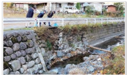
令和元年東日本台風の被害状況調査
