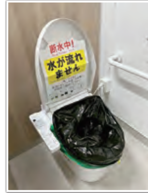
携帯トイレを使用したトイレ
