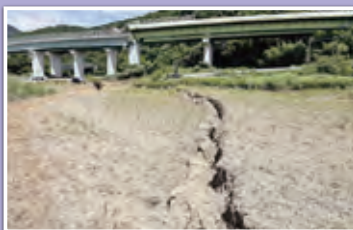
日奈久断層の地割れ
